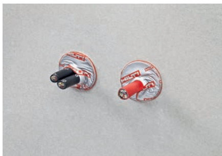
Datové a telekomunikační kabely
